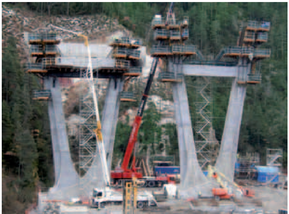
Pilas en el Túnel dels dos Valires, Andorra
